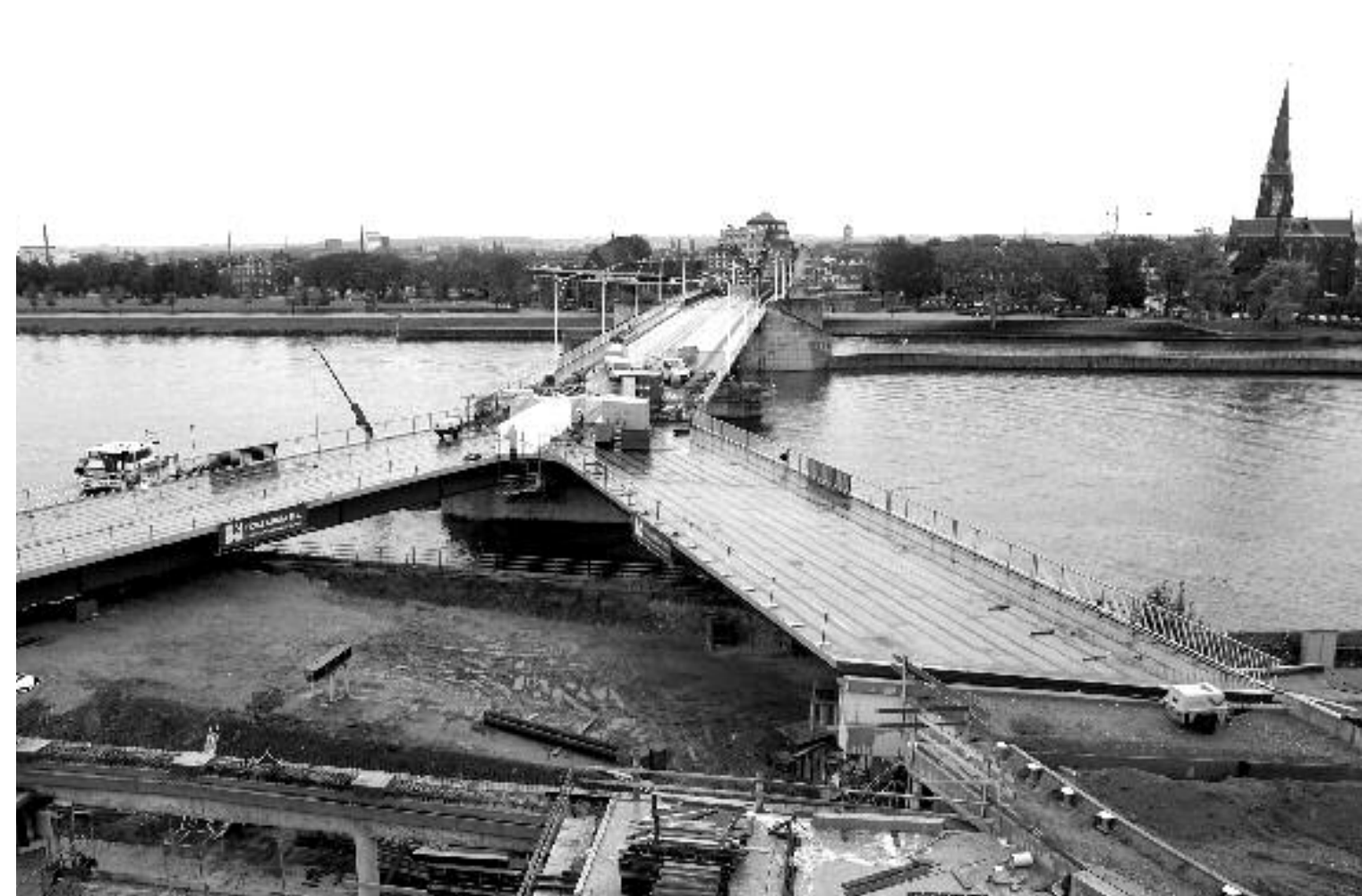
De aanlanding van de Wilhelminabrug op de Maasboulevard wordt aangepast t.b.v. Mosae Forum. Foto 2002.
